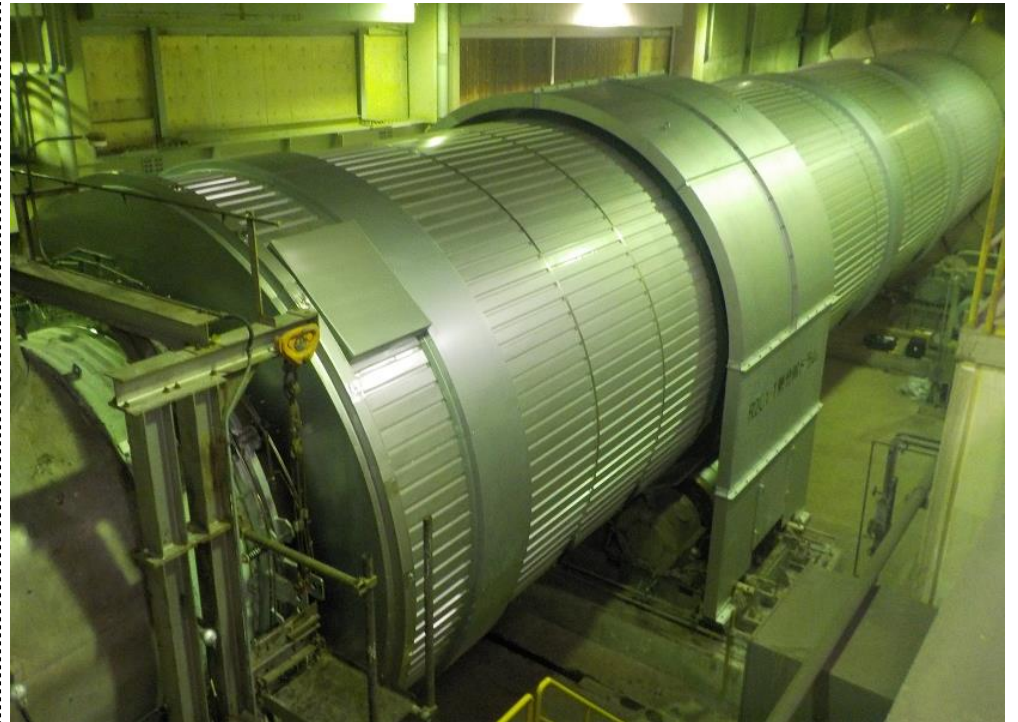
【📷】豊橋市資源化センター1号炉の熱分解ドラム竣工写真【平成30年12月28日】 新設できるまでの適切な維持管理は最重要事項ですが、点検整備業務・維持整備工事は契約どおり履行してきたと思われるだけに、事故の責任についてはメーカーとしっかり話し合いを！
